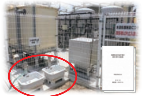
地下水飲料化設備
